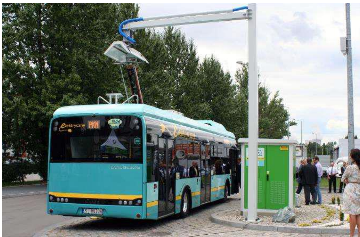
Rysunek 32. Pantografowa stacja ładowania autobusów elektrycznych w Jaworznie, źródło: https://www.transportpubliczny.pl/img/jaworznostacja1.jpg_678-443.jpg
